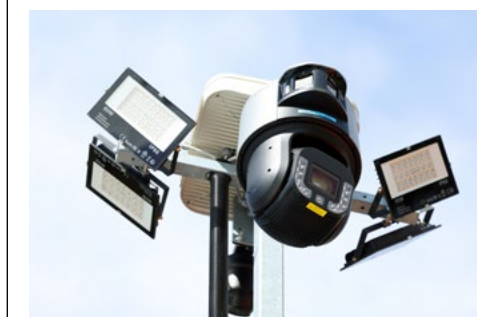
Goede terreinverlichting en camera-observatie dragen bij aan de veiligheid in en om de opvanglocatie
